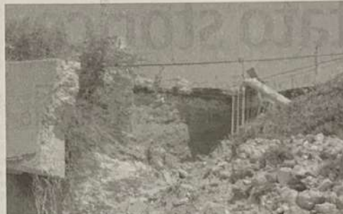
IL CROLLO DEL MANTO STRADALE DELL'ARTERIA CHE PORTA ALLA SPIAGGIA
