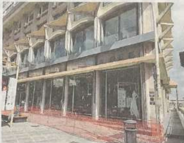
Il palazzo transennato di via Roma dopo il crollo di alcuni calcinacci
