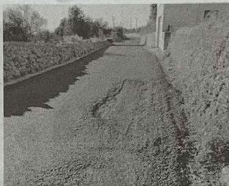
LA STRADA ASFALTATA E GIÀ DISSESTATA
