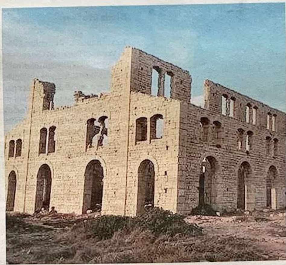
Industria. La fornace che rischia di crollare
