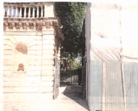
Lavori in corso ai Giardini iblei. Il sito non è pienamente fruibile da visitatori e turisti
