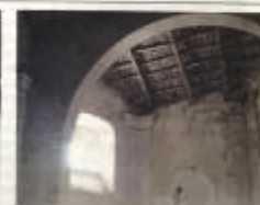
IL TETTO. Quando acquistò la chiesetta, Di Franco ne rifecce la copertura, spendendo l'equivalente della paga di decine di operai. Oggi ancora si vede l'itinerario della travatura lignea, che è da rifare.
